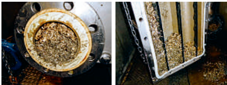
Circulation d'eau interrompue. Les moules bouchent les tuyaux et les filtres.
